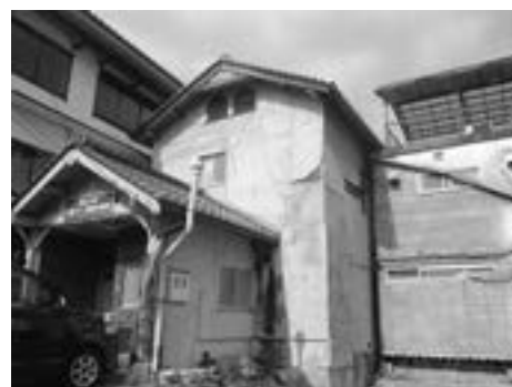
地震後使用中止となっている熱気浴施設
