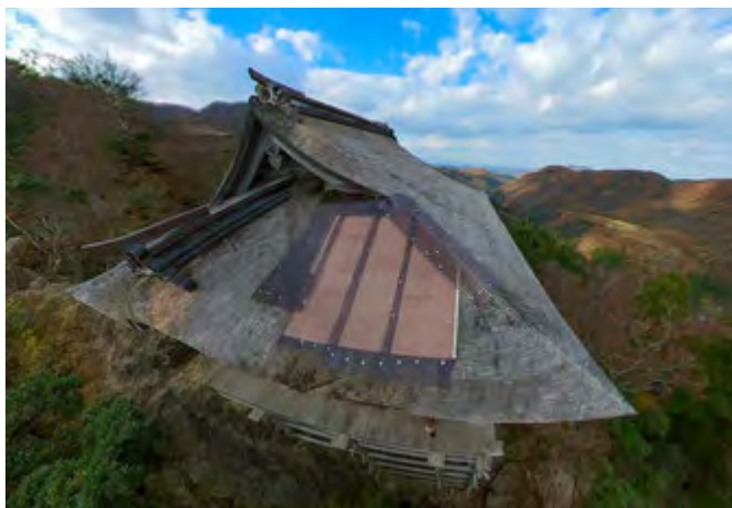
写真18 破損直後の三佛寺文殊堂
