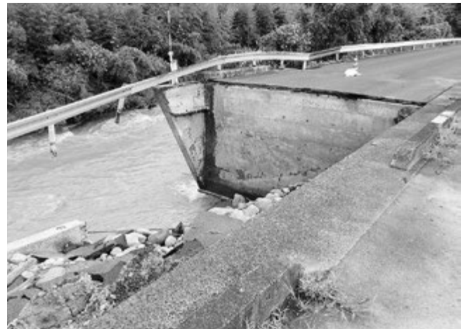
台風7号による被害
