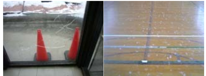
ホールのガラス破損 体育館に付いた無数の白い跡
